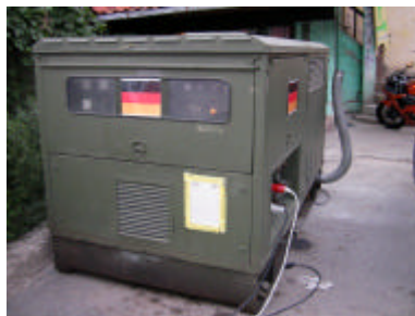
Einer der unzähligen Generatoren
